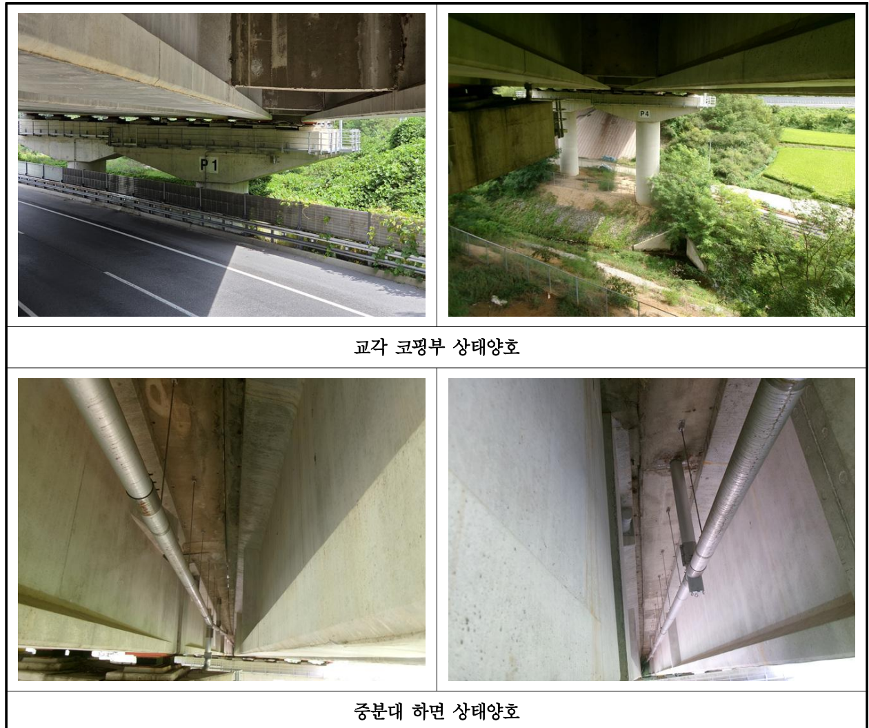
【사진 3.3.57】 교량의 공중이용시설 10대 위험요소 손상현황
